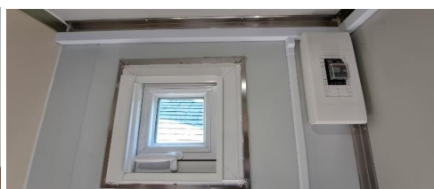
換気窓/照度センサー照明付
