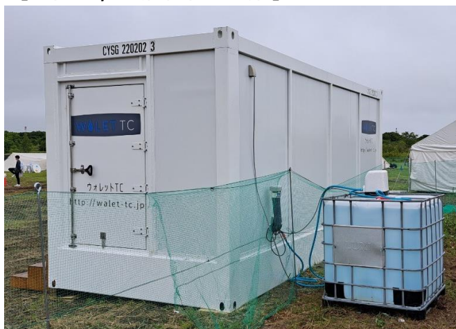
タンク+ポンプ+発電機使用例
