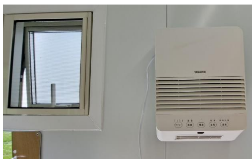
換気窓 & 暖房器具設置例
