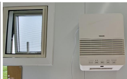
換気窓&暖房器具設置例
